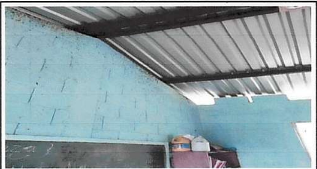
Foto 4: como se puede observar el problemas de plagas se encuentra afectando aula, cocina y bodegas, necesita sellar con block cemento arena para evitar el ingreso y evitar problemas de salud ✓
