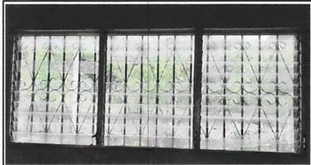
Foto 1: VENTAS EN MAL ESTADO CON VIDRIOS QUEDBRADOS ✓
