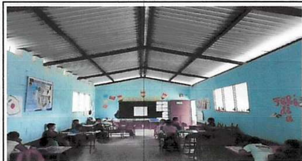
Foto 3: costaneras se encuentra con pintura dañada se necesita mantenimiento paraa largar su vida funcional ✓
